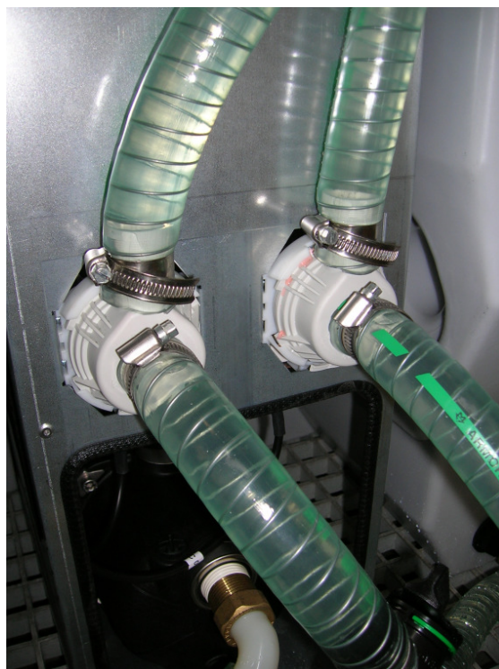
Conduites d'aspiration + conduites de refoulement
