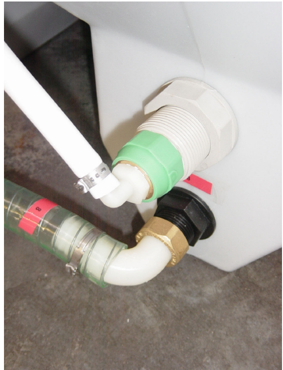
Raccord de l'unité de ventilation
