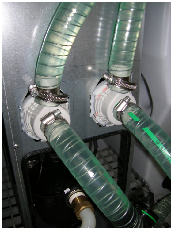
Tubería de aspiración + tubería de presión
